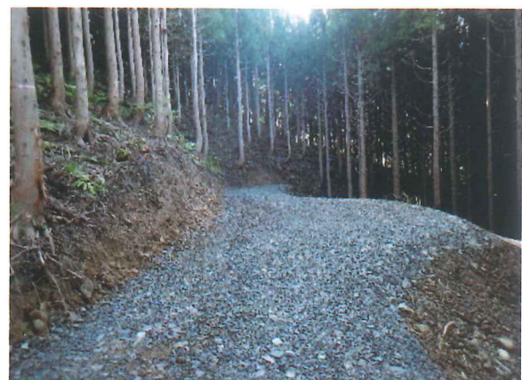
作業道開設後
